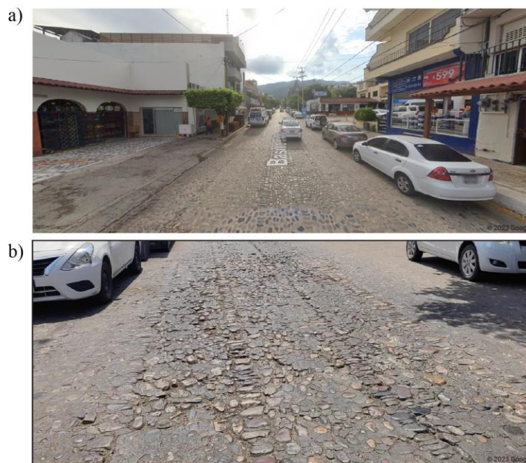
Figura 1. a) Vista al oeste de la calle Basilio Badillo en el área de estudio. b) Imágenes de fracturas con signos de hundimiento en la superficie de la calle.
